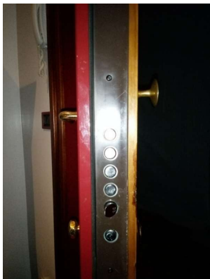
Foto 4: bordo porta, zona serratura
